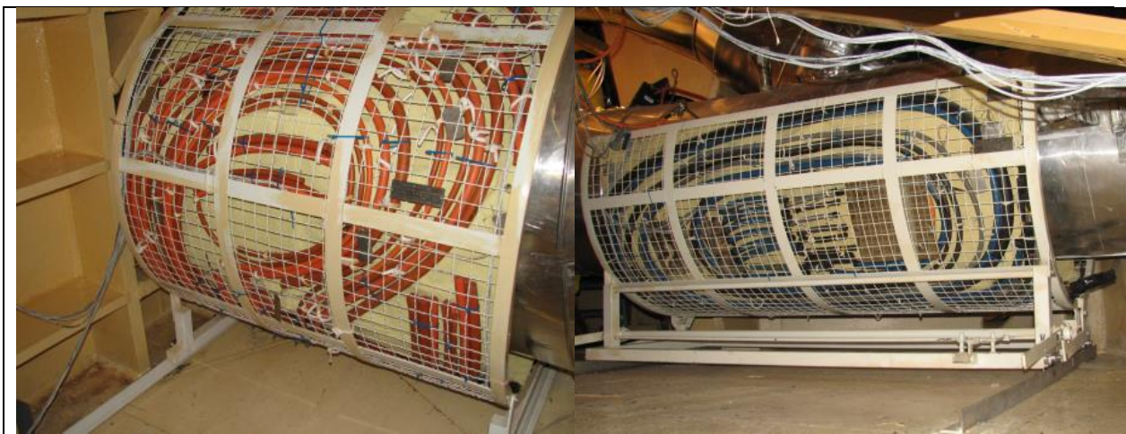
Obr. č. 3.3: Depozity se svědečnými kabely
