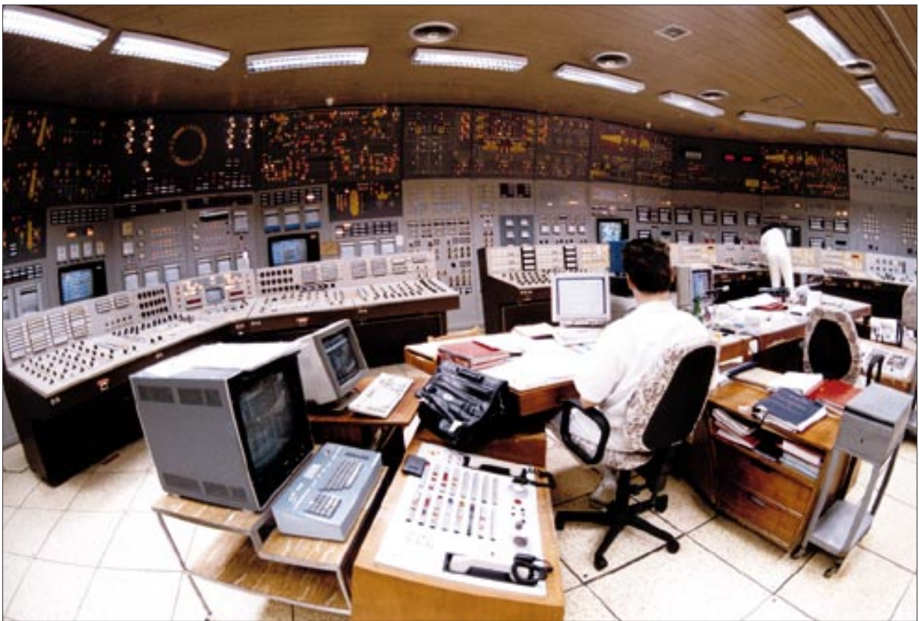
Jaderná elektrárna Dukovany - bloková dozorna
