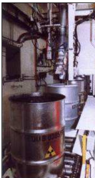
Obr. 4.5 Pohled na bitumenační linku na úpravu KRAO
