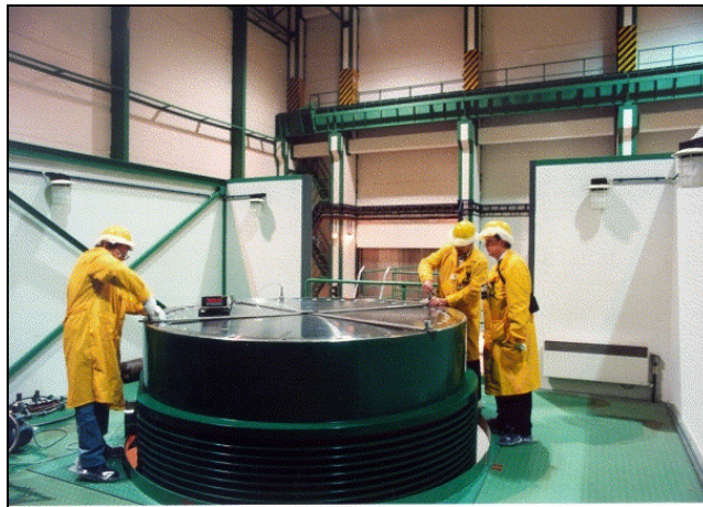
Obr. 7.5 Periodická kontrola tlakového snímače
