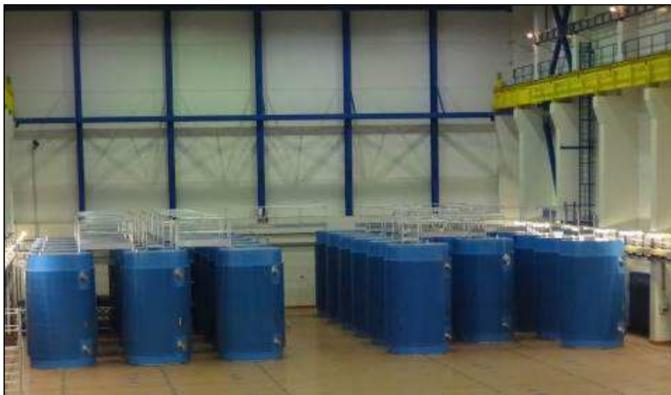
Obr. 4.2 Skladovací hala SVP Dukovany
