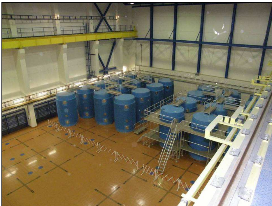
Obr. 4.2 Skladovací hala SVP Dukovany
